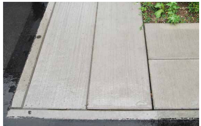
Wasserzufuhr durch Fugen
