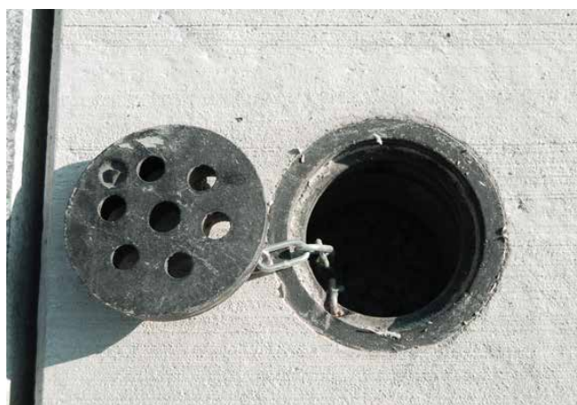
Belüftungs- und Bewässerungsstutzen
