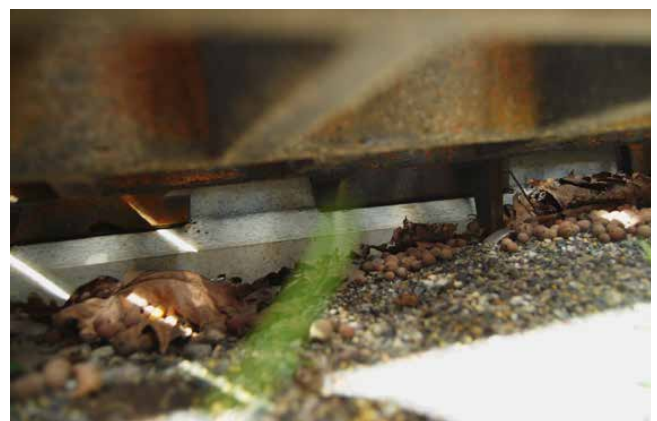
Genügender Zwischenraum unter der Abdeckung
