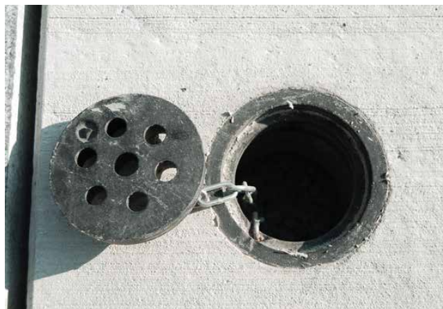
Belüftungs- und Bewässerungsstutzen
