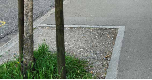
Ungeschützter Wurzelraum führt zu hoher Bodenverdichtung
