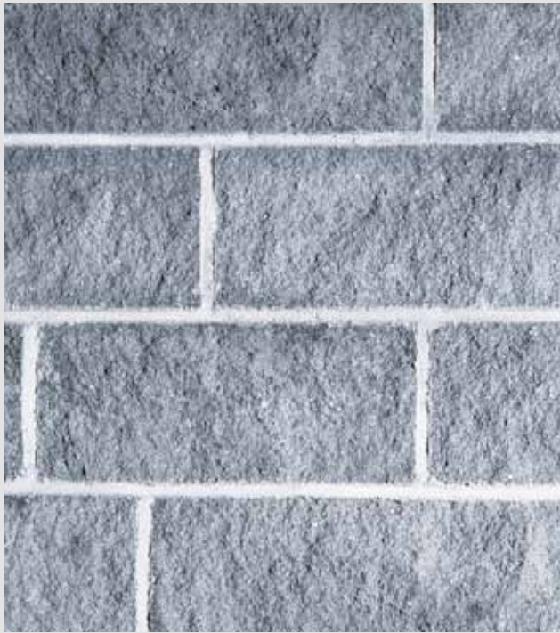
Mörtelfuge aus Trasszement («normaler Zement» blüht aus)
